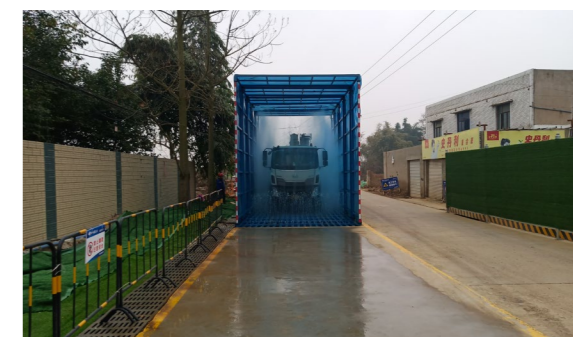
立体全方位车辆冲洗装置
